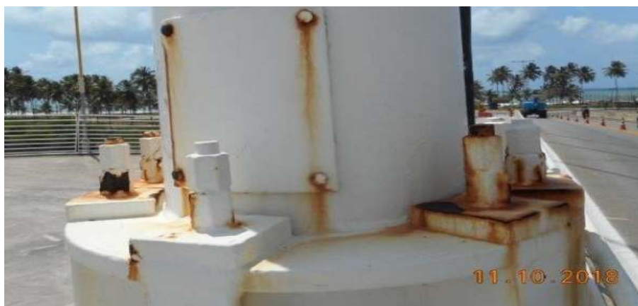
Figura 3. Corrosão dos parafusos e arruelas da fixação da base dos mastros dos estais.
