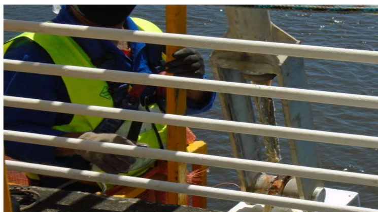
Figura 9. Análise das ancoragens e cordoalhas de todos os estais, comprovando as boas condições.
