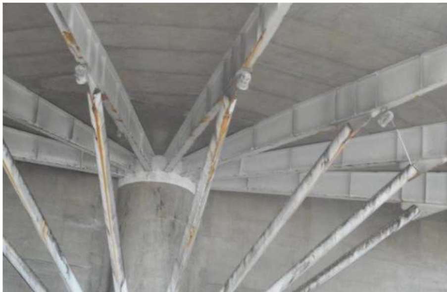
Figura 7. Elementos da estrutura no nível do piso das praças, com corrosão entre moderada e média.
