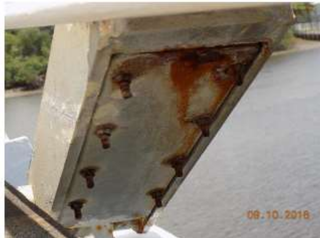
Figura 6. Situação típica das ancoragens inferiores com os parafusos e tampa de proteção corroídos.
