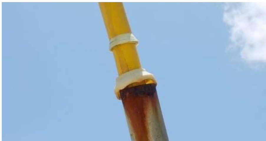
Figura 5. Danos nos elementos de transição entre os estais e os tubos antivandalismo.
