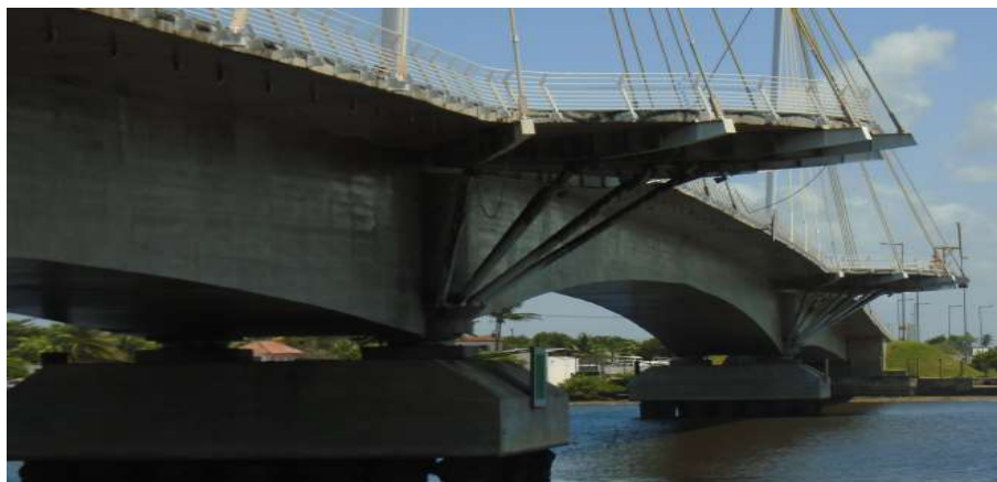
Figura 1. Vista da estrutura metálica das praças apoiada na estrutura de concreto da ponte.
