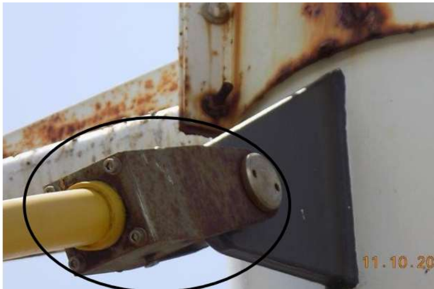
Figura 4. Corrosão dos dispositivos de fixação dos estais na extremidade superior do mastro.
